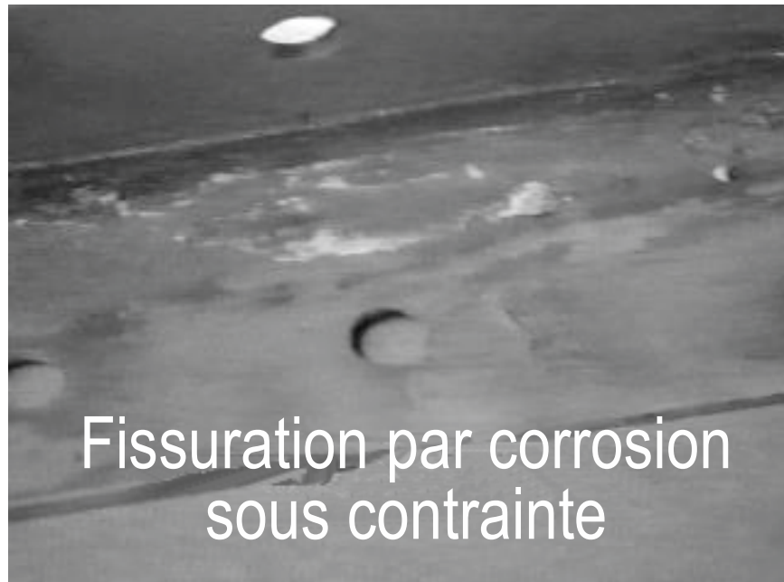
Figure III-9-74. La fissuration par corrosion sous contrainte peut être identifiée par la présence de plusieurs fissures fines dans les alliages à haute résistance.
